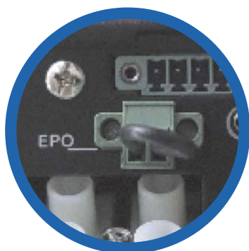
Apagado de Emergencia (EPO)
